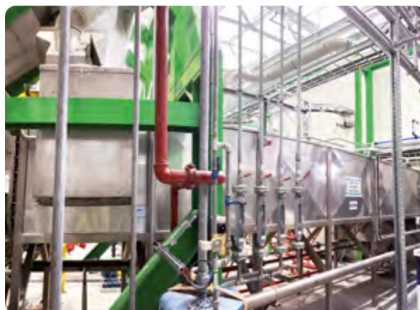
Vasca di prefloatazione | Pre-floatation trough
